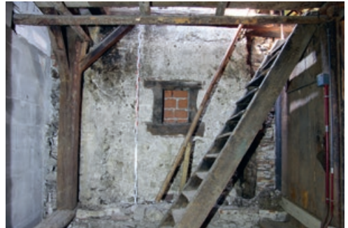
3.3 Südliche Giebfassade mit bauzeitlichem Lehmflechtwerk. Der Mörtelputz und das Fenster sind jüngere Zutaten aus der Zeit vor 1652
